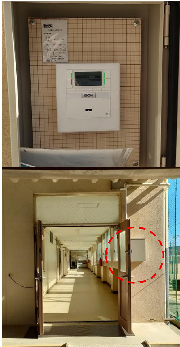
(写真) 設置したシステム機器
