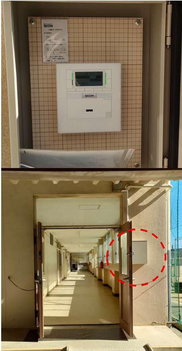
（写真）設置したシステム機器
