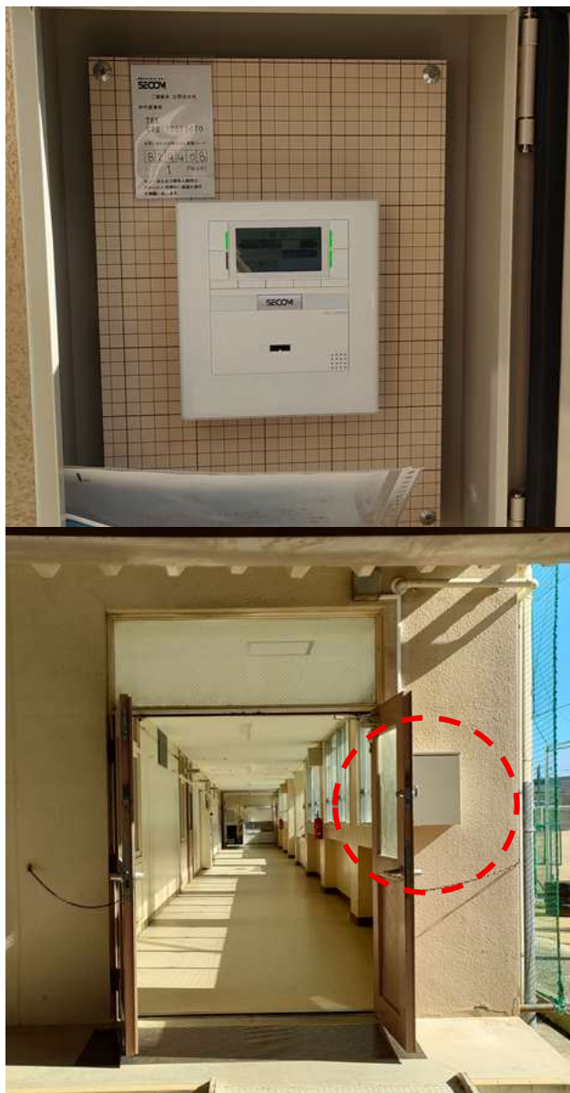
(写真) 設置したシステム機器
